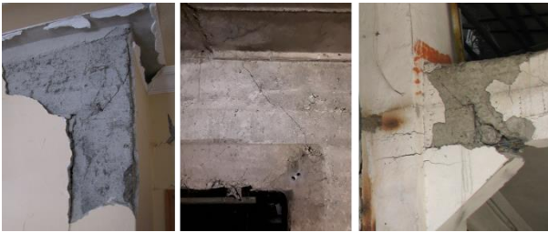
Şekil 11. Kolon-kiriş birleşim bölgesi hasarları.
