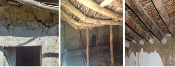
Şekil 26. Çatı-duvar bağlantısının yeteri düzeyde sağlanamaması.
