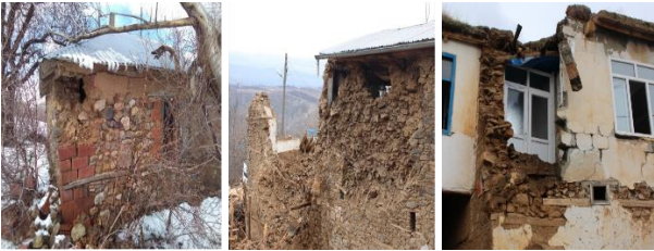
Şekil 27. Köşe duvarlar arasında yeterli bağlantının olmaması.
