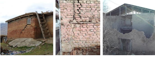
Şekil 25. Hatıl kullanılmamasından dolayı oluşan hasarlar.
