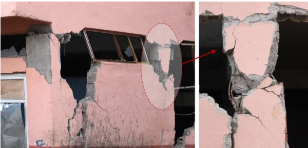
Şekil 15. Kısa kolon oluşumuna örnek.
