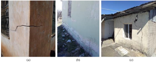
Şekil 30. Yığma yapılarda gözlenen düzlem içi hasar davranışı: (a) çekme çatlakları, (b) eğilme çatlakları, (c) diyagonal çekme çatlakları.
