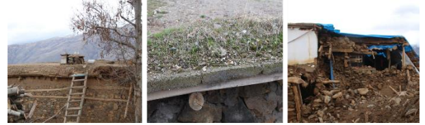
Şekil 24. Ağır toprak kullanımdan dolayı oluşan hasarlar.
