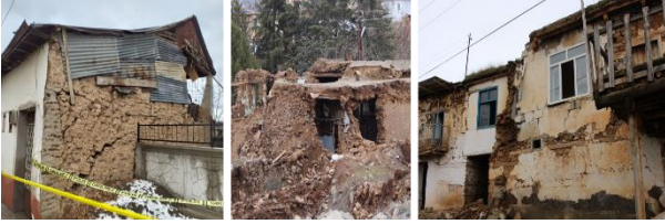
Şekil 22. Düşük dayanımlı malzemeye bağlı hasarlar.
