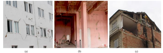
Şekil 21. Yapısal olmayan hasar örnekleri: (a) dış cephe kaplama elemanlarında dökülmeler, (b) bölme duvar çatlakları, (c) çatı hasarı.
