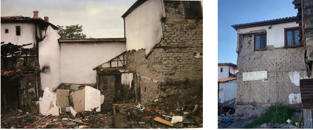
Şekil 10. Kuzey ve doğu duvarlarının yangın sonrası durumu (VGM ve yazar arşivi)
