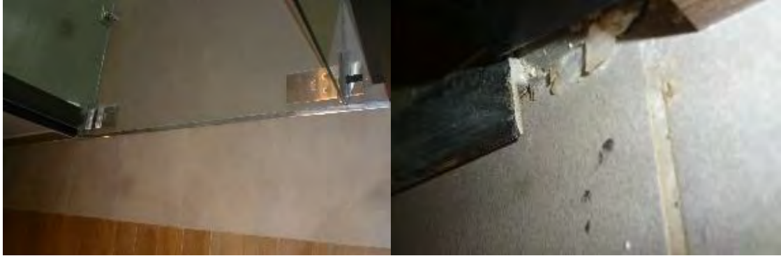
Şekil 7. Armada Rezidans Fitness Salonu – Ana Hol Bağlantı Bölgesi (1-2 Nolu Birleşim Bölgesi) (Mazlum, 2019, s. 64)
