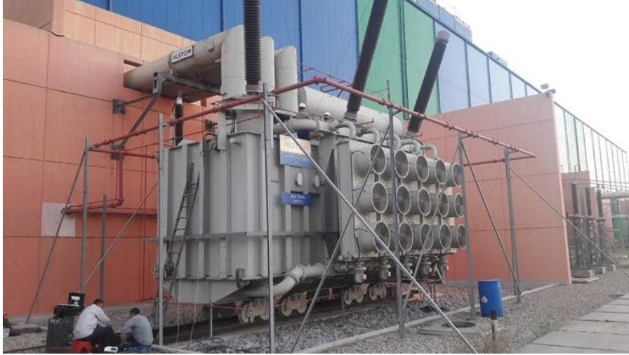
Şekil 1. Trafonun genel görünümü.
