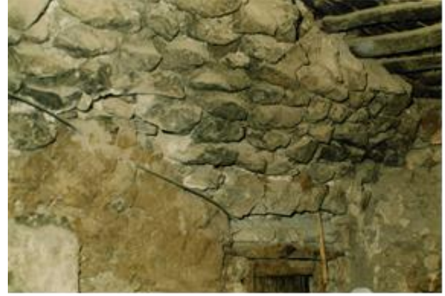
Şekil 7: Avlunun yıkık üst örtüsü
