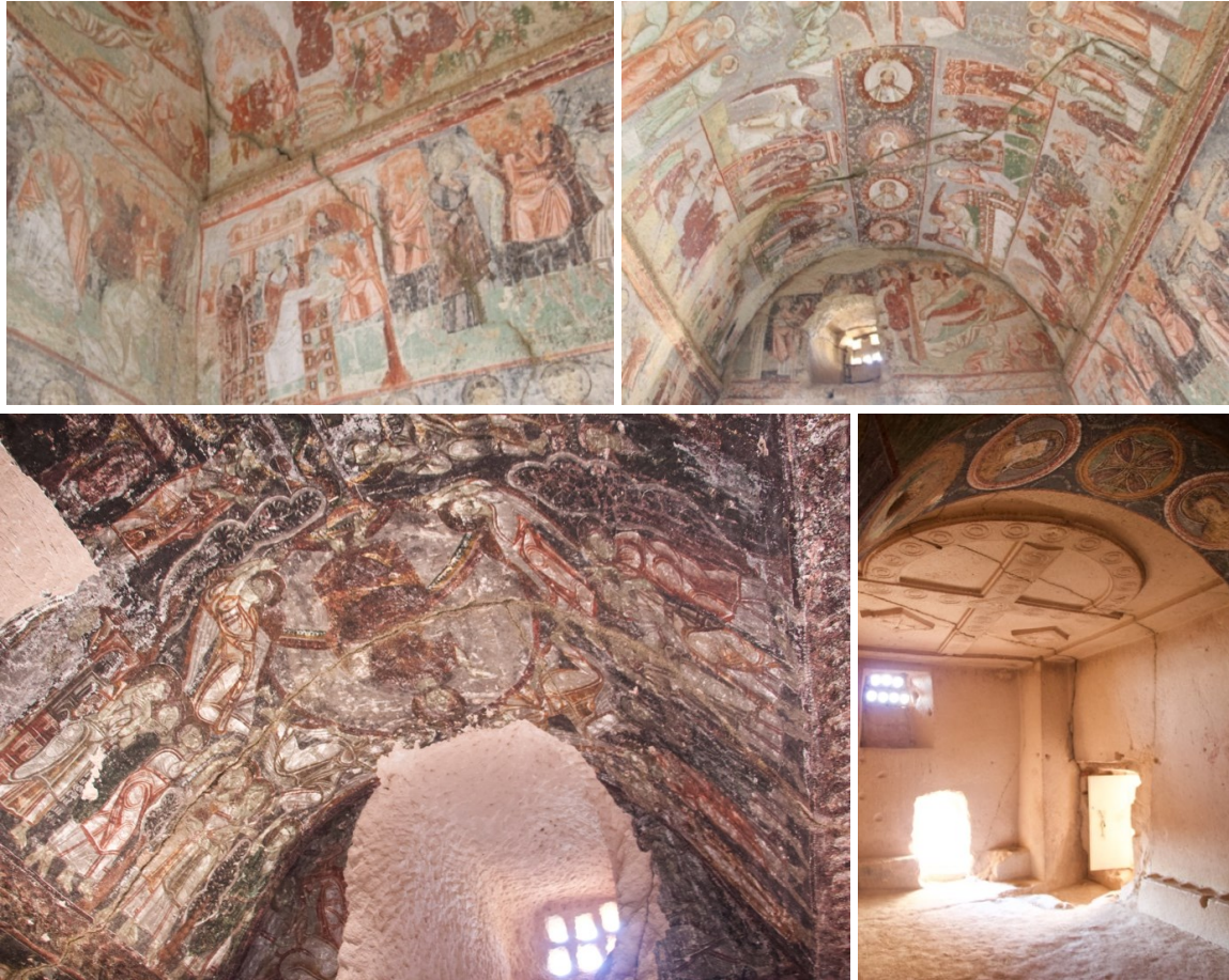
Fotoğraf 7. Çavuşin, Ayvalı ve Haçlı Kilisesi Duvarlarında Yapısal Çatlaklar
