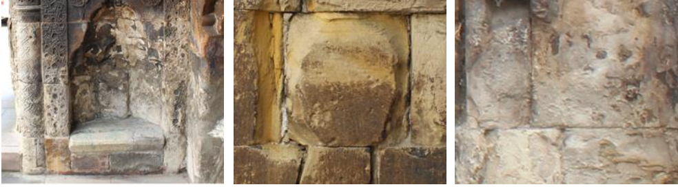
Fotoğraf 12: Taç Kapı, Sağ Kuşak Alt Kısım, Aşınma-Ufalanma, Parça Kaybı
