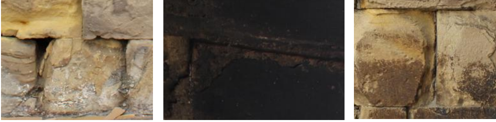
Fotoğraf 5: Taç Kapı, Sağ Destek Duvarında Harç Boşalması Fotoğraf 6: Taç Kapı, Yuvarlak Kemer Tonozunda Harç Boşalması Fotoğraf 7: Taç Kapı, Sağ Destek Duvarında Harç Aşınma-Ufalanması
