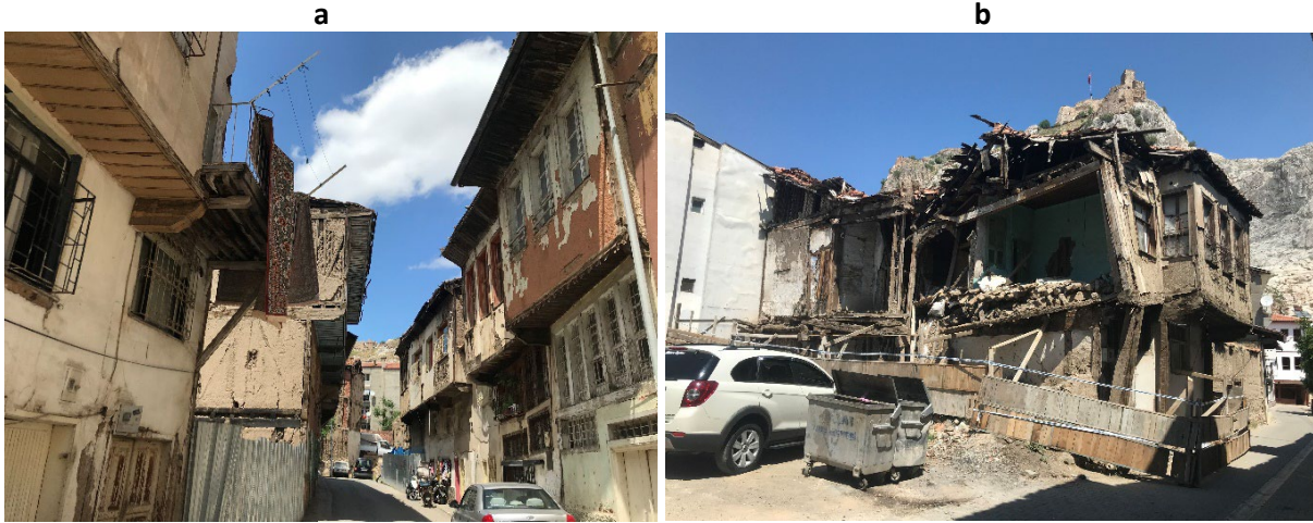
Fotoğraf 5: Sulusokak çevresinde yer alan ve yenilenmeyi bekleyen çok sayıda yapı bulunmaktadır (a-b).
