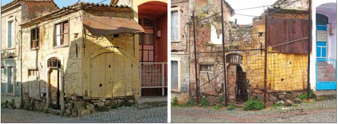
Fotoğraf 12. Tarihi yapının 2012 ve 2018 yıllarındaki görünümü (2012: Bergama Belediyesi, Rölöve ve Restorasyon Birimi Arşivi; 2018: Pergamon Kazı Arşivi). / Views of the historic building from 2012 and 2018 (2012: Bergama Municipality, Archive of the Documentation and Restoration Department; 2018: Pergamon Excavation Archive).
