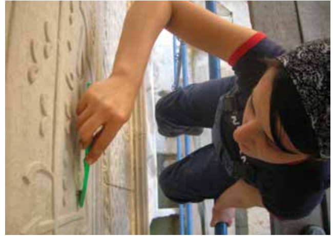
Fotoğraf 3. KOREFD'in Kültürel Mirasın Korunması Sürecinde Kalifiye Uygulama Elemanı Yetiştirme Programı kapsamında şantiye eğitiminde uygulama yapan bir katılımcı / A participant in the construction site training within the scope of KOREFD's Qualified Implementation Staff Training Program for the Process of Conservation of Cultural Heritage (F: Nurdan Kuban, 2006)
