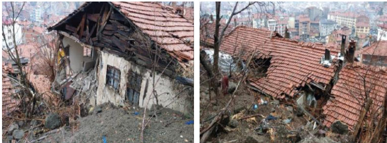
Şekil 3. Hacıpiri Mahallesi Kaya Düşmesinden Etkilenen Konutlar (İRAP, 2021).
