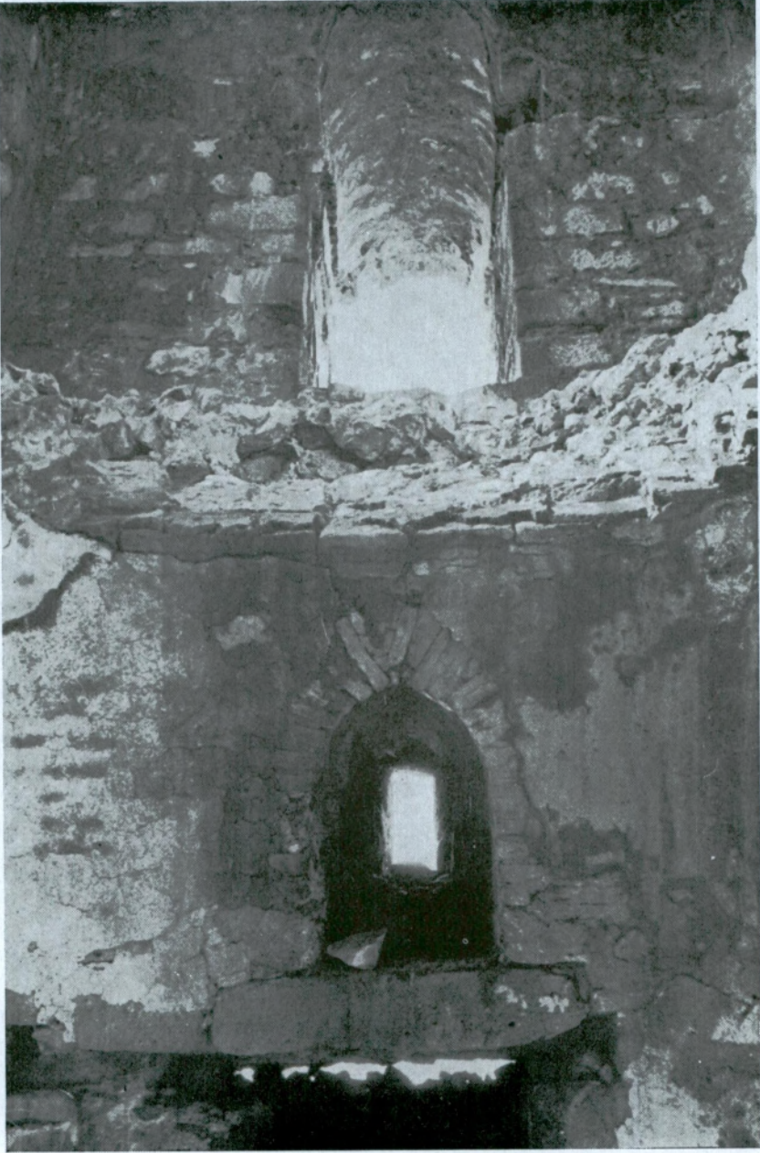
Resim 15 — Birinci Kat Döşemesinin Çökmüş Olan Ön Kısından Görünüş ve Zemin Kattaki Güneybatı Yönüne Açılan Sivri Kemerli Mazgal Pencere
