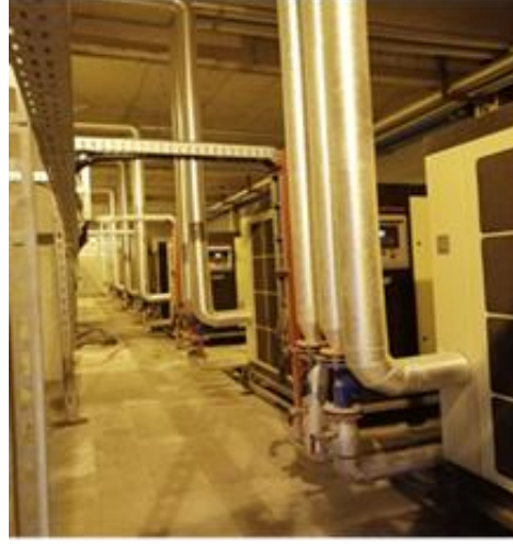
Şekil 5. Kompresör odası genel yerleşimi
