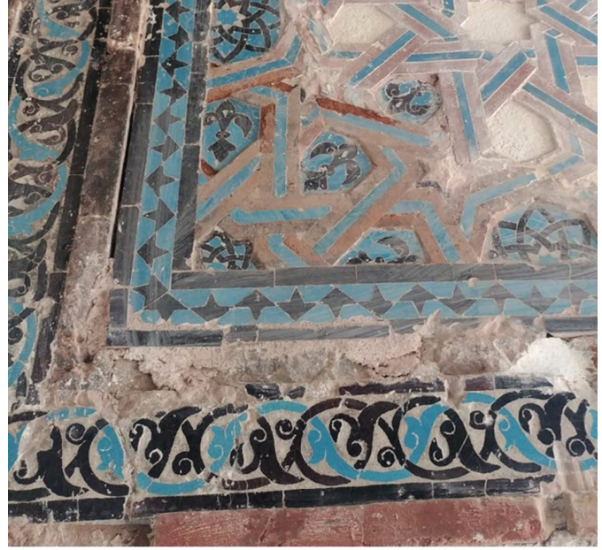
Resim 15. Medrese, Kuzey Eyvan Arka Duvar Üst Kısım, Parça Kaybı (Konak)
