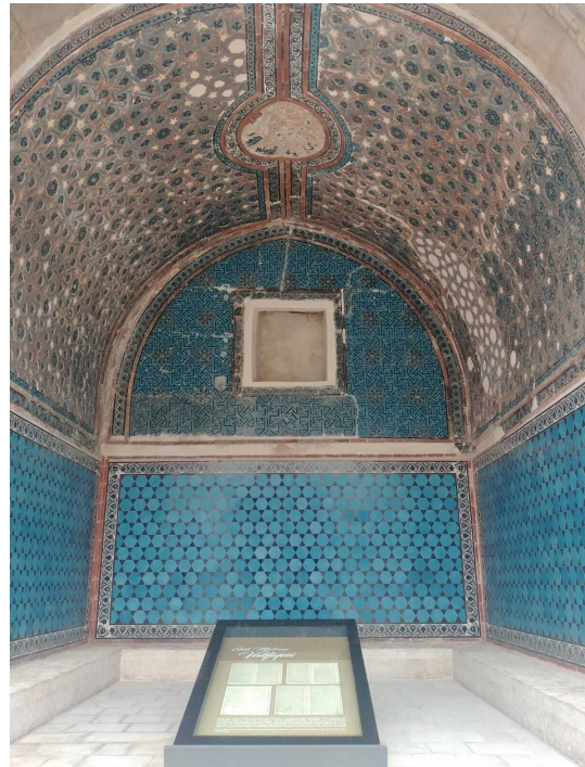
Resim 16. Medrese, Güney Eyvan Tonoz Örtü Göbek, Parça Kaybı (Konak)
