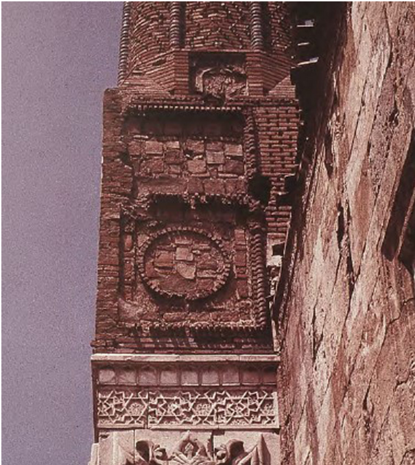
Resim 1. Medrese, Güney Minare Kaide Kısım, Güney Cephe, Birim Malzeme Kaybı (Tuncer, 2008)
