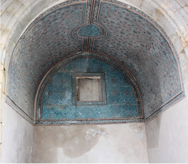
Resim 13. Mescit, Kuzey Eyvan Arka ve Yan Duvarları, Birim Malzeme Kaybı (Sivas Vakıflar Bölge Müdürlüğü)
