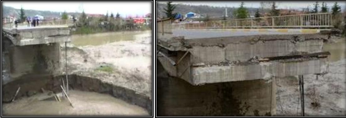
Şekil 7. Köprünün yıkılmasının ardından köprü tabliyesi (KGM, 2012)
