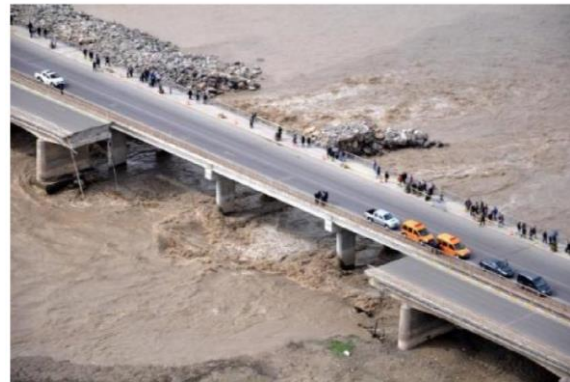
Şekil 1.b İncelenen köprünün kısmi çöken görüntüsü (KGM, 2012)
