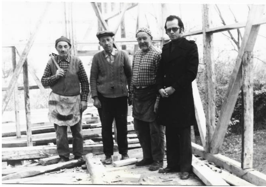
Şekil 11. Safranbolu'da yapılan ilk restorasyon Nezihe Aycan evi restorasyonu, ustalar ve yüksek mimar Yavuz İnce
