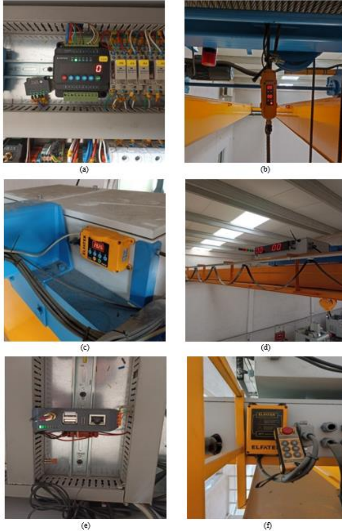
Şekil 14. Tasarlanan sisteme ait saha uygulaması Figure 14. Application of the designed system
