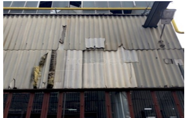
Şekil 3: Asbestli levha ile kaplı bir yan cephe [8]
