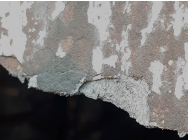
Şekil 4: Hasarlanmış çatı kaplama malzemesi
