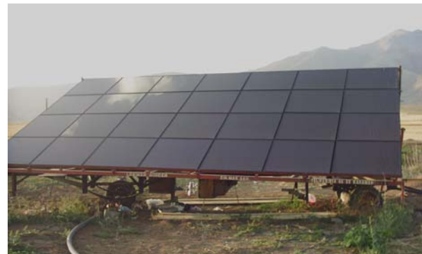
Şekil 7 Sunset PV panelleri
