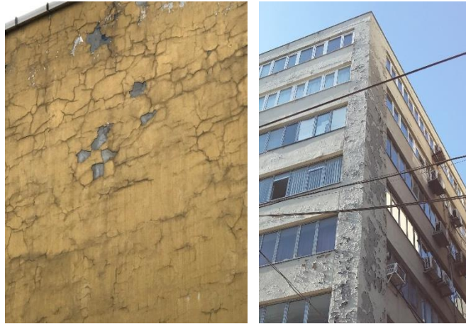
Şekil 10: Cephe yüzeyinde meydana gelen boya soyulmaları ve dökülmeler (Fot. Erturan B.)
