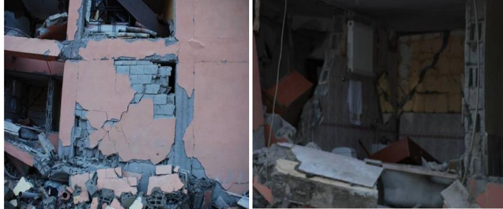
Şekil 65,66. Dolgu Duvar Hasarları (URL-9)
