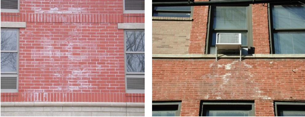
Şekil 2: Cephe yüzeyinde tuz birikmesi sonucu oluşan beyaz lekeler (Loughran, 2007, s.3-6)
