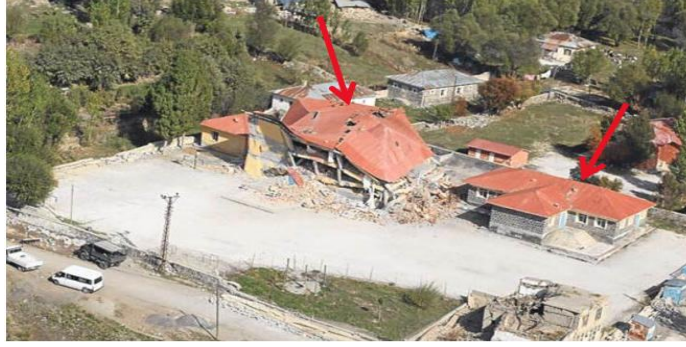
Şekil 72. Van Gedikbulak Köyü 1952'de Yapılan Yıkılmayan (Sağda), 1988'de Yapılan Yıkılan (Solda) Köy Okul Binaları (Kaynak Anonim).
