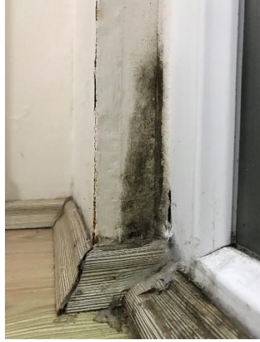
Şekil 25: Dış cephe iç kaplamasında oluşan küflenme (Fot. Erturan B.)
