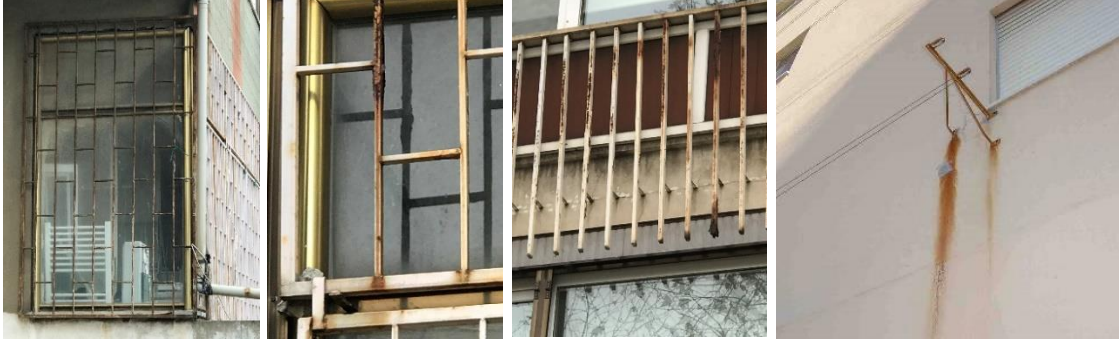
Şekil 3: Çeşitli cephe elemanlarında görülen korozyon sorunu ve korozyon nedeniyle oluşan yüzey lekelenmeleri ((a,b,c) Foto. Erturan B.; (d) Freitas, 2013, s.116)
