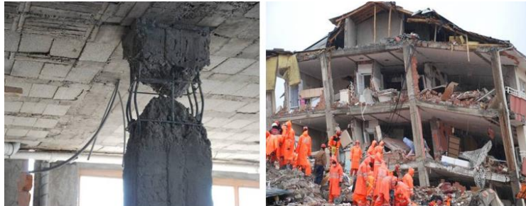
Şekil 63,64. Van Kent Merkezi Yetersiz Sargı Donatısı, Asmolen Döşeme Ağır Malzeme ile Cephe Kaplamalı Ağır Bina Örnekleri
