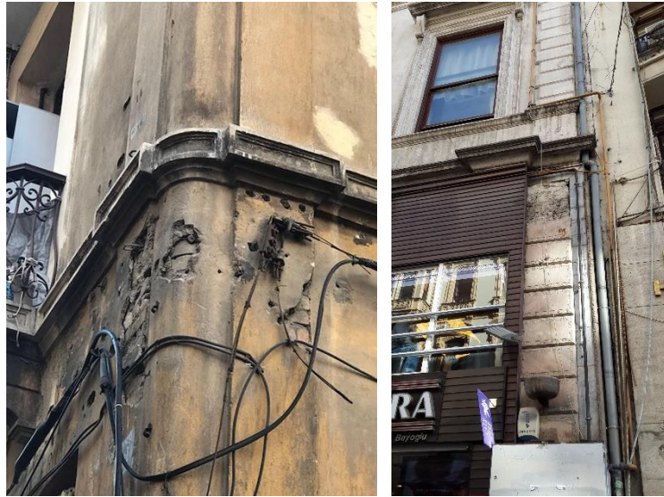
Şekil 28. Cepheye yapılan müdahalelerin cephede oluşturduğu bozulmalar (Fot. Erturan B.)
