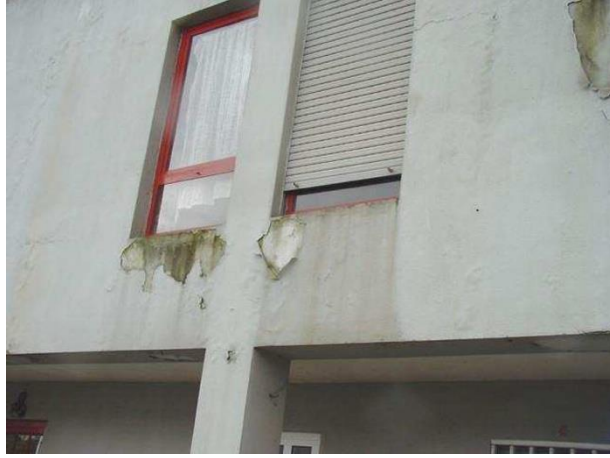
Şekil 12: Denizliği olmayan pencerenin altından akan yağmur sularının neden olduğu kabarma ve dökülmeler (Freitas, 2013, s.126)
