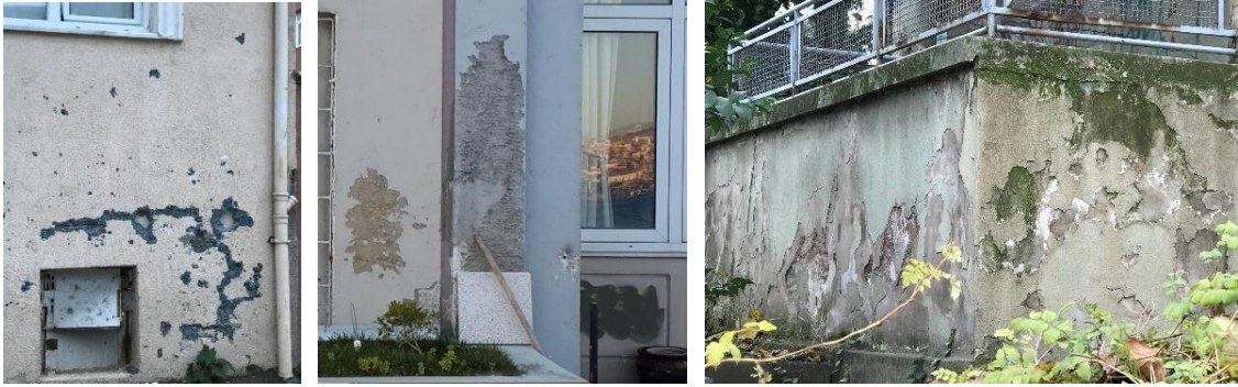
Şekil 20: Cephede oluşan malzeme aşınmaları (Fot. Erturan B.)
