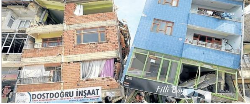
Şekil 46. Van Depreminde Çarpışma/Çekiçleme Etkisiyle Yıkılan Yapılar (URL-9)
