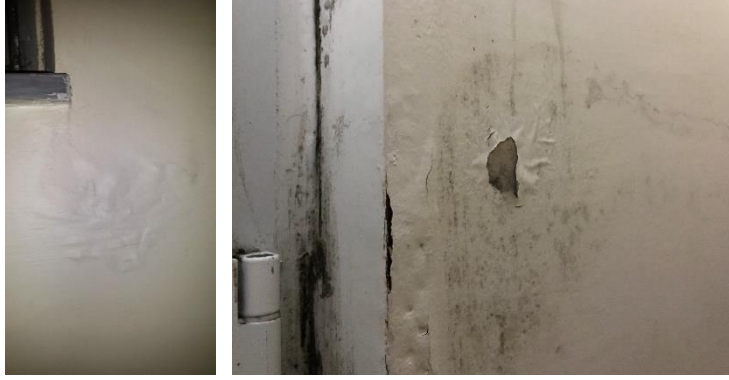
Şekil 11: Pencere doğramalarından sızan su nedeniyle iç mekanda oluşan kabarma (solda) ve dökülmeler (sağda) (Fot. Erturan B.)
