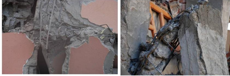
Şekil 61,62. Kuvvetli Kiriş-Zayıf Kolon Oluşumu
