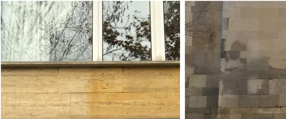
Şekil 15: Taş yüzeyinde görülen renk değişimi (Fot. Erturan B.)
