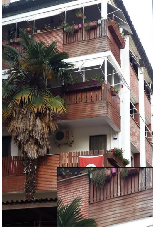
Şekil 14: Cephedeki tuğla ve ahşap kaplamalarda oluşan renk değişimleri (Fot. Erturan B.)
