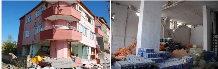
Şekil 67,68. Yapılarda Tasarım Hatalarına Örnek (Van-Erciş)
