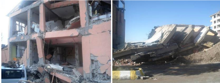
Şekil 48,49. Van Erciş İlçesi Ağır Hasarlı Betonarme-Karkas Yapı Örnekleri
