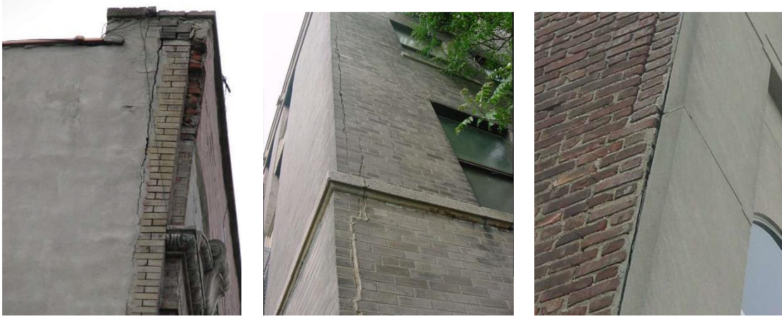
Şekil 23: Duvarda oluşan düşey çatlaklar ve ayrılma (URL-5)
