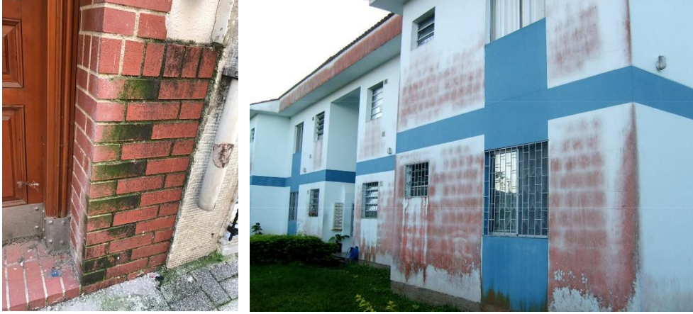
Şekil 27: (a) Cephede yeşil renk oluşumuna neden olan yosunlanma (solda) (Fot. Erturan B.), (b) Cephede kırmızı renk oluşumuna neden olan yosunlanma (sağda) (Breitbach ve Viotti, 2012)
