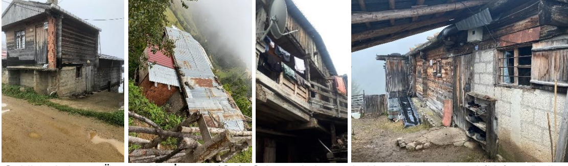
Şekil 8: Aşhane Üstüne Kat İlavesi (G5), Oda ve Aşhanenin Kısmi Büyütülmesi (K7) ve Balkona Tuvalet Eki (G6, K17) (Topcu, 2021)
