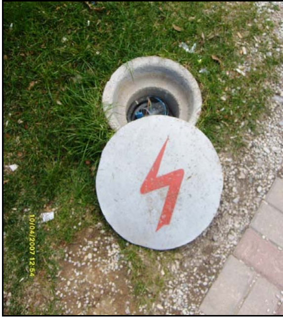
Şekil 10. Nenehatun parkında açıkta duran elektrik kabloları (Orijinal 2007).
