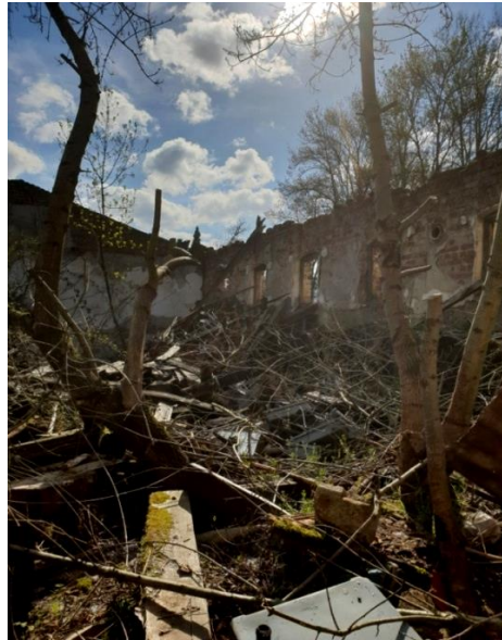
Figür 8. Z02 ahır mekânının çökmüş çatı karkası ve günümüzdeki durumu
