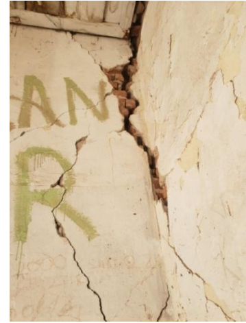
Figür 10. Kuzey duvarındaki yapısal çatlak
