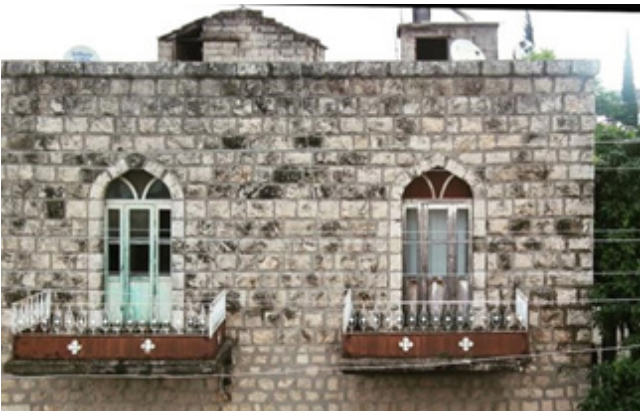
Figür 13: Batı Cephesi Küpeşteler ve Balkonlar Restorasyon Öncesi ( https://www.facebook.com/focusrestorasyon/posts/111147553686782/ Erişim Tarihi:13.05.2023)
