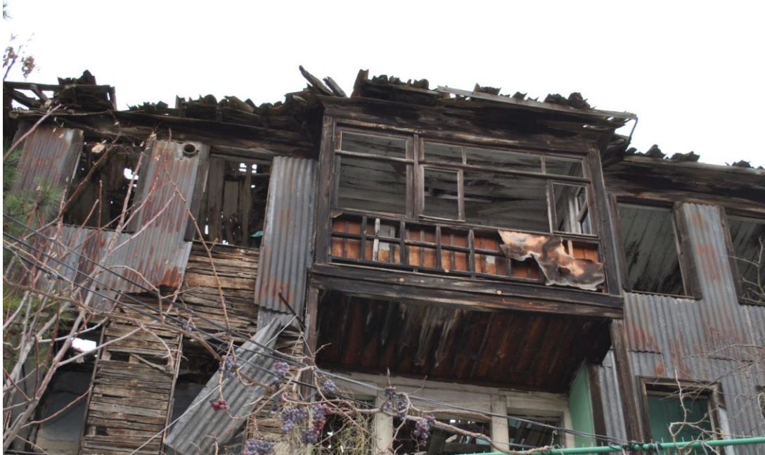
Şekil 1. Bozulmaya uğramış ahşap yapı örneği (Betülner Hülügü, 2019)
