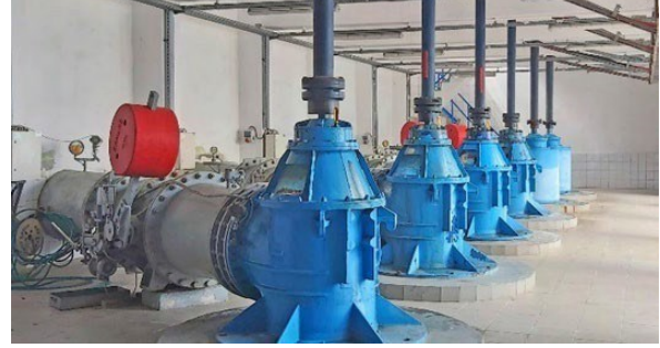
Şekil 3. TM-1 pompa istasyonu
