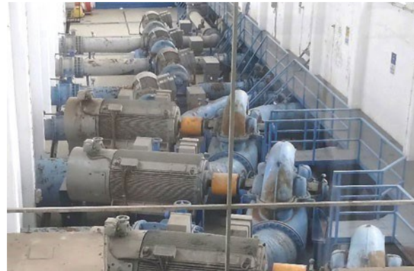
Şekil 5. TM-2 pompa istasyonu
