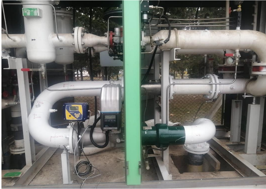
Şekil 2. Bölge regülatörünün revizyon sonrası hali
