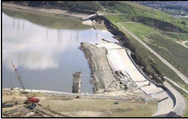
Şekil 2. San Fernando (1971) depreminde sıvılaşma sonucu oluşan hasarlar (Koçkar, 2022)
