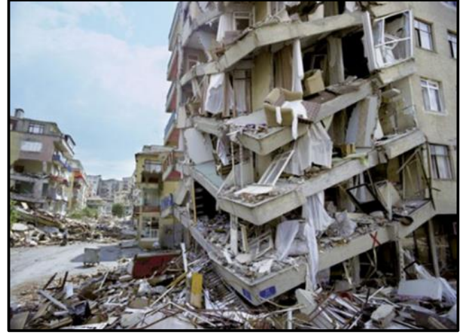
Şekil 3. Kocaeli (1999) depreminde sıvılaşma sonucu binada oluşan hasar (URL-1, 2023)
