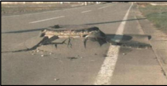
Şekil 15. Niigata (2004) depreminde sıvılaşma nedeniyle oluşan hasar (Altındış, 2020)
