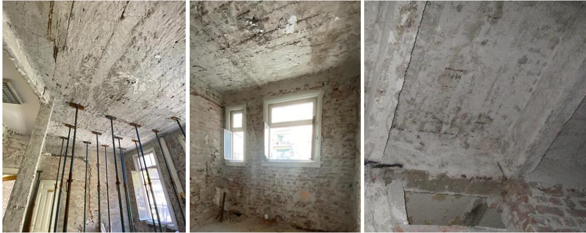
Şekil 6 - Betonarme sistemde izlenen segregasyon ve donatı korozyonu sorunları (11.12.2020).
