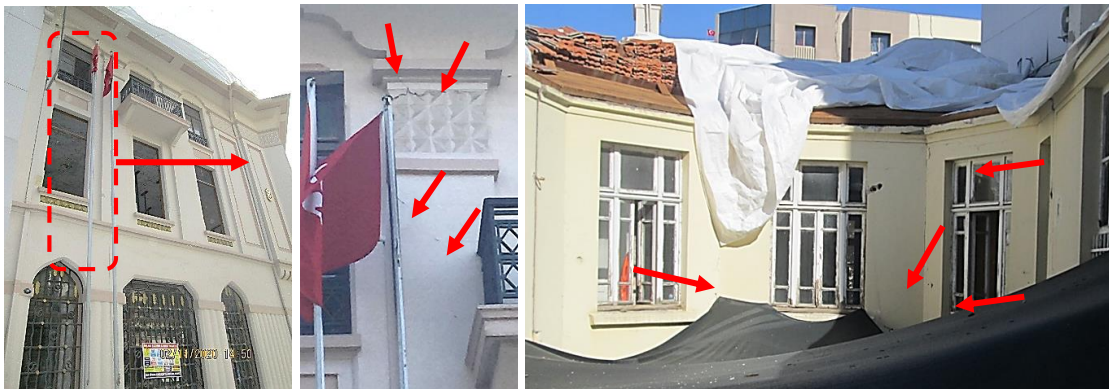
Şekil 4 - 30 Ekim 2020 tarihli deprem sonucunda meydana gelen hasarlar (03.11.2020).
