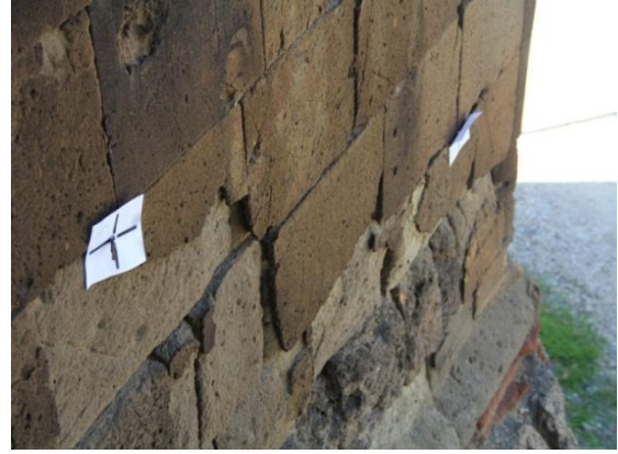
Fotoğraf 10. Kuzey cephe aşınmış kaplama taşları
