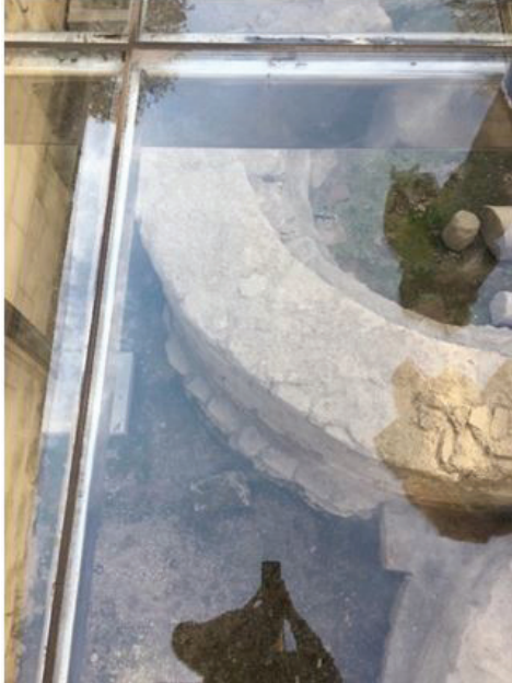
G. 22: Cam döşeme malzemesindeki korozyonlar (Neşe Karaçay, 2018)
