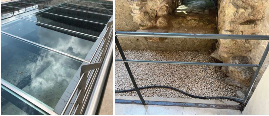
G. 14: Cam döşemede malzeme bozulmaları (Neşe Karaçay, 2018); Kalıntıların bulunduğu döşemelerin çatlaklar ve kırılmalar (Neşe Karaçay, 2022)
