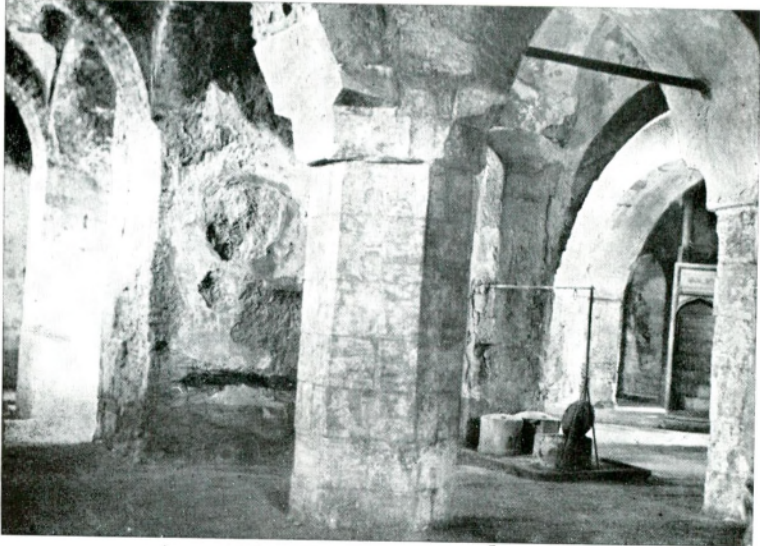
Res. 8 — Galeri ve nartekslerdeki bodur ve kalın sütun ve pilpayeler. Fig. 8 — Massive piers in gallery and narthex.
