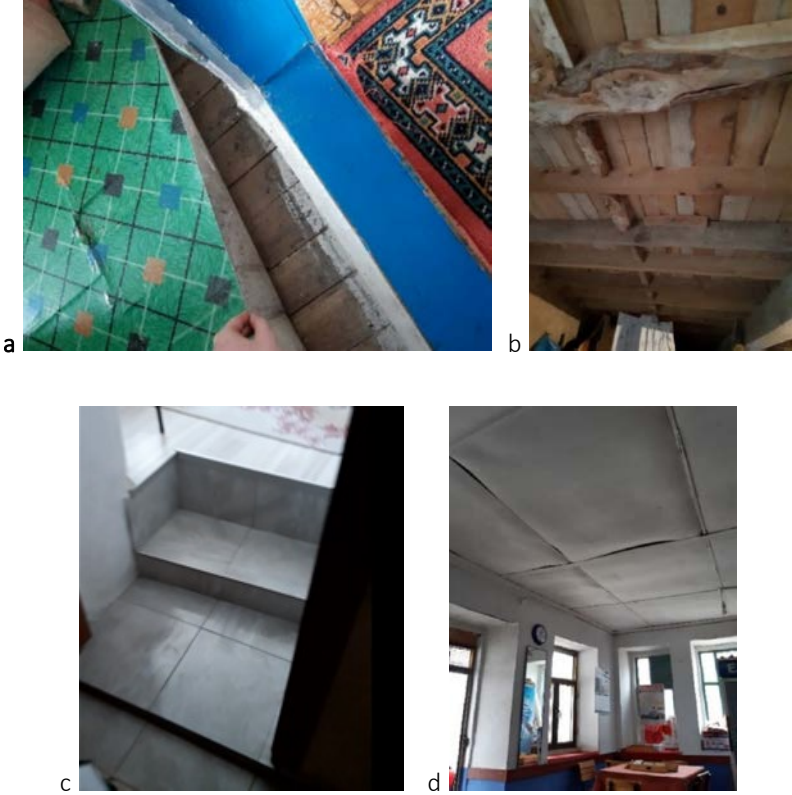
Şekil 17. a. ENV-3 Ahşap döşeme b. ENV-3 Ters tavan c. Muhdes döşeme d. KTLG-3 Kontrplakla kapatılmış tavan.
