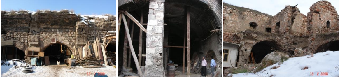
Foto. 14. Develerin Konakladığı Ahırlarda Görülen Yapısal Hasarlar ve Depo Kullanımları, 2008 (Tokat Vakıflar Bölge Müdürlüğü)
