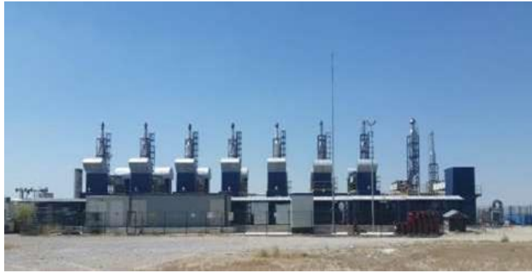
Görsel 7. Kaşınhanı Elektrik Üretim Tesisi
