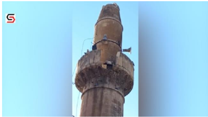
Şekil 7. Külâh kısmından hasara uğramış minare (Siverek Sulu Camii minaresi tehlike saçıyor, 2023)
