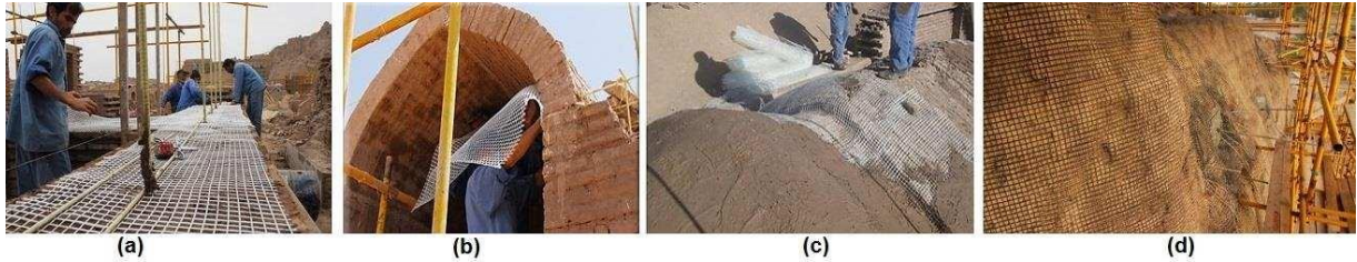
Şekil 11. (a) Kerpiç duvarların dikey olarak fiberglas çubuklarla güçlendirilmesi ve kerpiç duvarların yatay olarak fiberglas ağlarla kaplanması; (b ve c) kerpiç çatıların iç ve dış kısımlarının cam elyaf ağların döşenmesi yoluyla stabilizasyonu; (d) 1 No'lu Kule'nin cephesinin fiberglas ağlarla stabilize edilmiş hali. (Aveta, Marino ve Rouhi, 2017)
