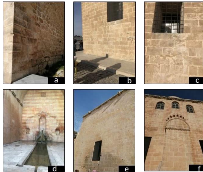
Figure 6. Chemical deterioration in Kasımiye Madrasah (Biçen Çelik, 2019)
