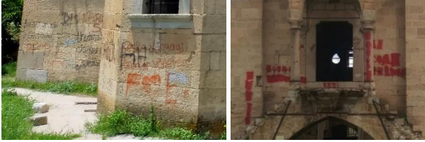
Şekil 20. Doğu ve Batı cephelerindeki vandalizm etkileri [36]
