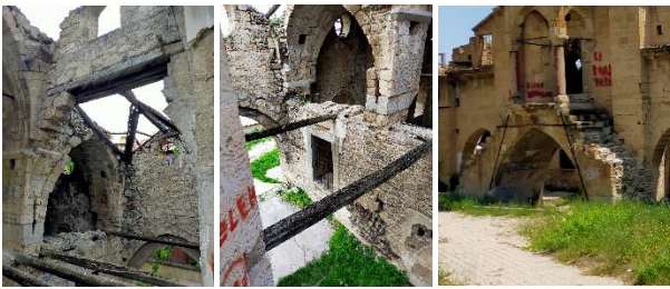
Şekil 21. Çan kulesi ve Narteks kısmındaki bozulmalar [36]
