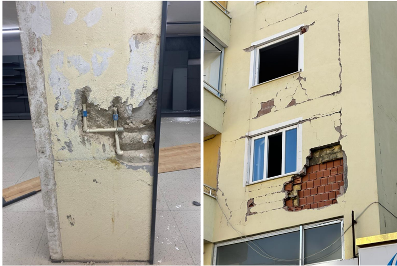
Görsel 11. Kolon Yüzeyindeki Tesisat Boruları (Solda), Dış Duvarda Görülen Hasar (Sağda).
