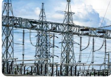
Görsel 2.121: Elektrik nakil hatları
