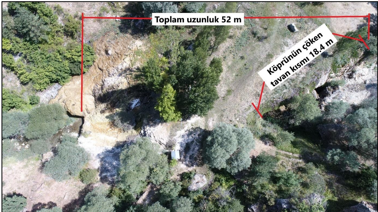
Fotoğraf 3. Aktepe Traverten Köprüsü'nün toplam uzunluğu yaklaşık 52 m olup, giriş kısmında 18,4 m'lik bölümü çökmeye uğramıştır.
