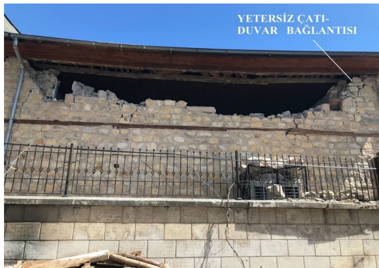
Şekil 5. Yetersiz Çatı- Duvar Bağlantısı (Duraklı Camii) (Weak Roof-Wall Connection (Duraklı Mosque))
