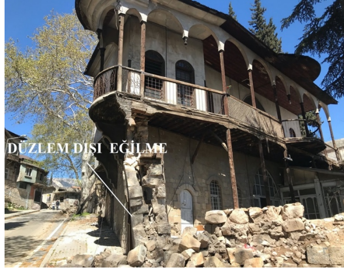
Şekil 7. Narinlik oranı yüksek duvarda çökme (Kayabaşı mahallesinde bir konak) (Wall collapse with high fragility (a mansion in Kayabaşı neighborhood))
