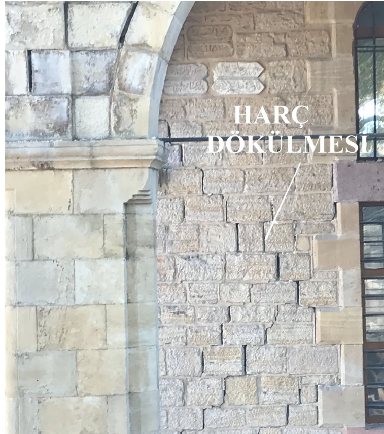
Şekil 13. Harç dökülmesi (Çukuroba Camii) (Damage to the mortar (Cukuroba Mosque))
