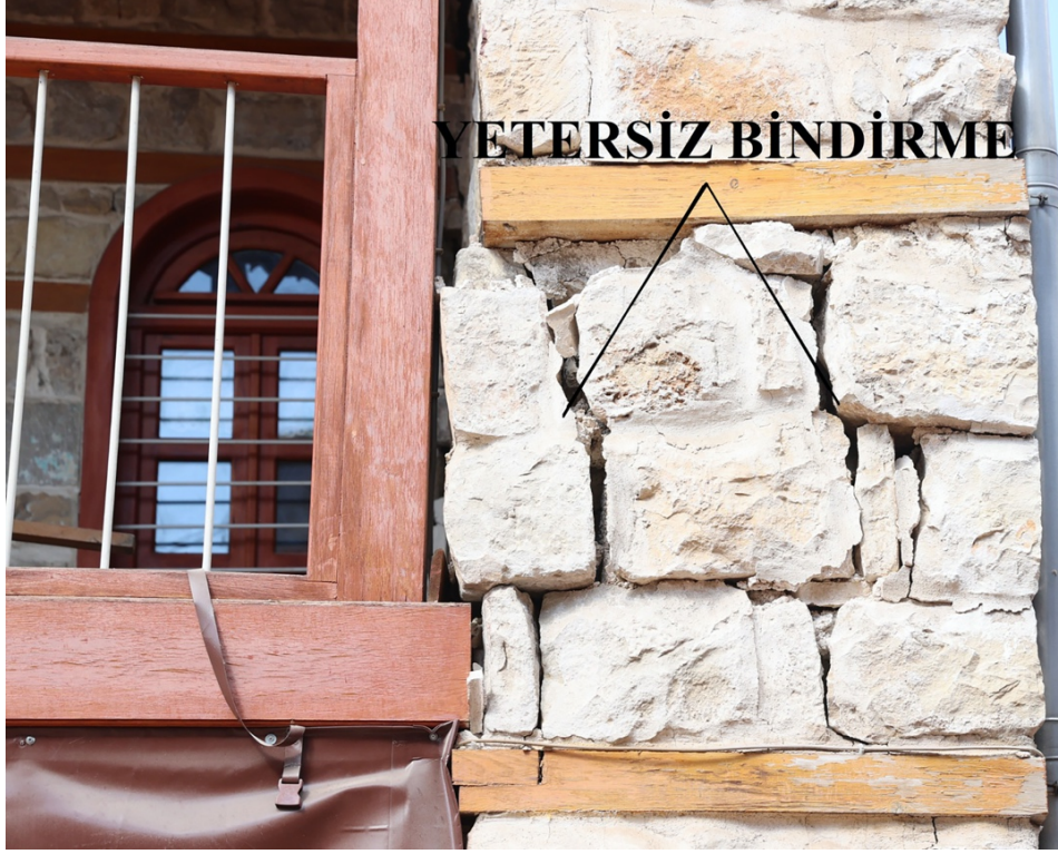
Şekil 15. Yetersiz bindirmeden dolayı oluşan çatlak (Mutfak Müzesi Konağı) (Crack caused by insufficient overlap) (Kitchen Museum Mansion)
