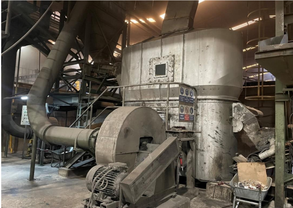
Şekil 2. Kum kurutma sisteminin fotoğrafı (Photo of the sand drying system)
