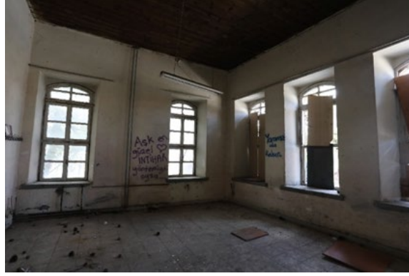
Şekil 21. Senirkent Turan İlköğretim Okulu zemin kat kuzeybatı köşedeki oda (Kişisel Arşivden)
