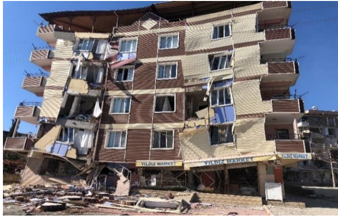
Şekil 1: Ağır hasarlı yapı örneği Nurdağı Yeni Mahalle
