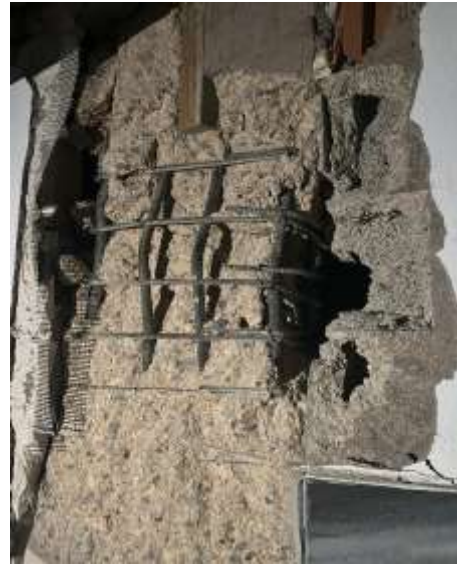
Şekil 11. Perde yetersizliğinden dolayı gözlenen hasar
