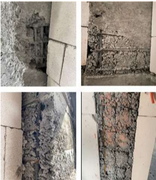
Şekil 5. Yapılarda gözlenen segregasyon oluşumları
