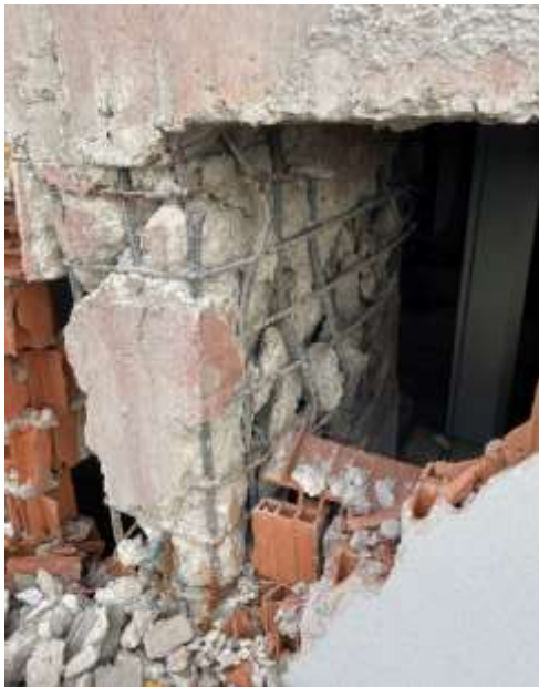
Şekil 10. Kısa kolon hasarı
