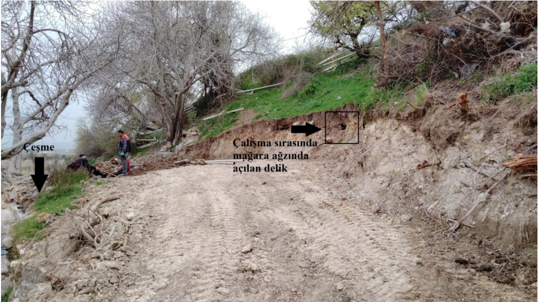
Resim 2: Çalışma sırasında düzleştirilen alanın yamacında açığa çıkan delik, tünelin ağız üst kısmına denk gelmektedir.
