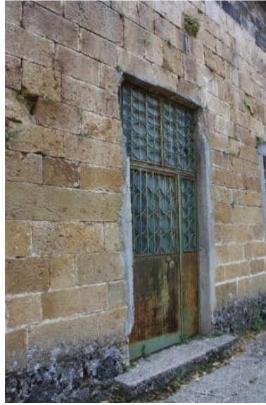
Şekil 16. Niğde Yeşilburç Kilisesi Değişen Kapı [18]
