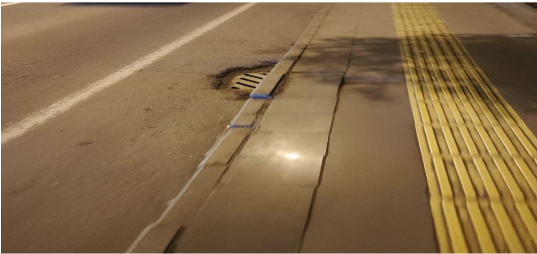
Şekil 10. Mevcut yolda yetersiz yağmur suyu giriş ızgarası
