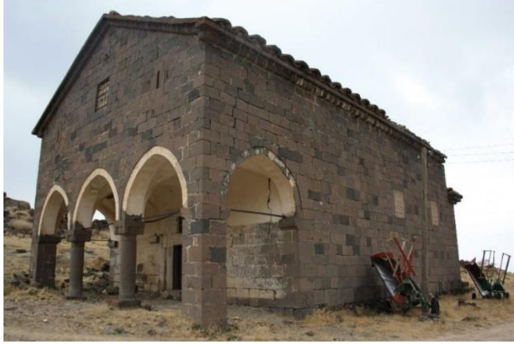
Şekil 10. Niğde Ballı Köyü Kilisesi, Derin Çatlak [18]
