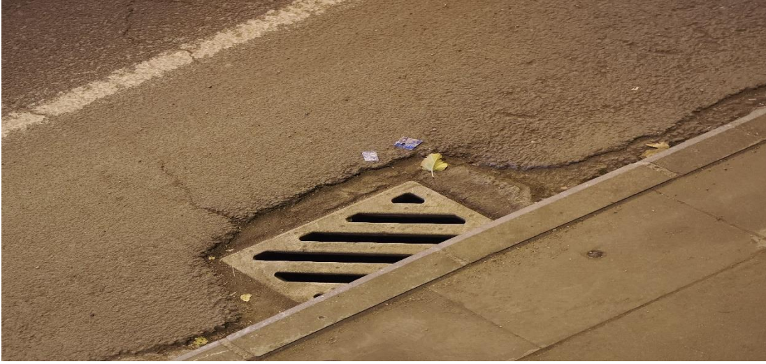
Şekil 9. Su tahliyesi yapılmaması sonucu oluşan tahribat
