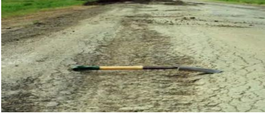
Şekil 1. Drenaj yetersizliğinden kaynaklı oluşan oturmalar
