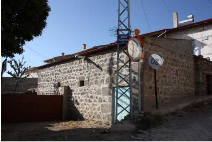
Şekil 11. Niğde Çömlekçi Köyü Kilisesi, Çatı, bitişiğinde konut inşa edilmiş, Sol nef kaybı [18]
