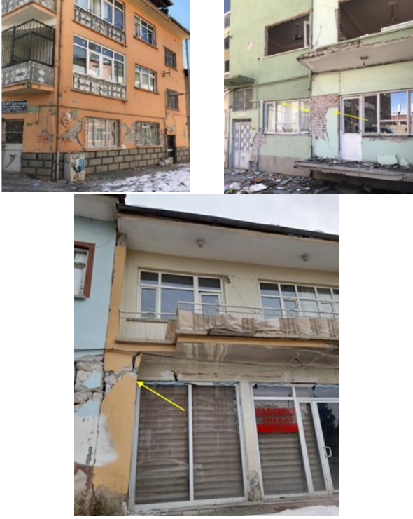
Şekil 11. Uygun olmayan duvar boşlukları nedeniyle meydana gelen hasarlar
