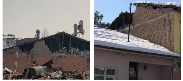
Şekil 14. Yığma binalarda kalkan duvarlar hasarları
