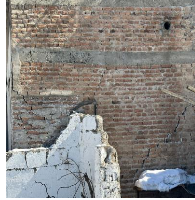
Şekil 9. Düzlem içi davranış hasarları
