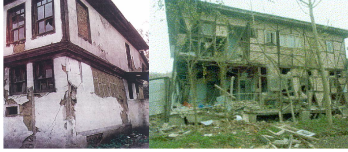
Şekil 8. Hımsıy yapıda dolgu dökülmesi (Doğangün vd., 2006)
