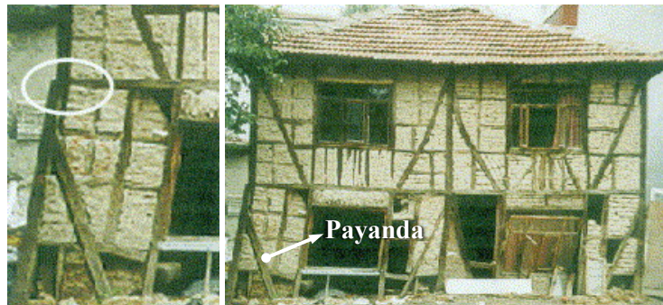
Şekil 7. Bağlantı noktasında hatalı uygulama, Kocaeli (Doğangün vd., 2006)
