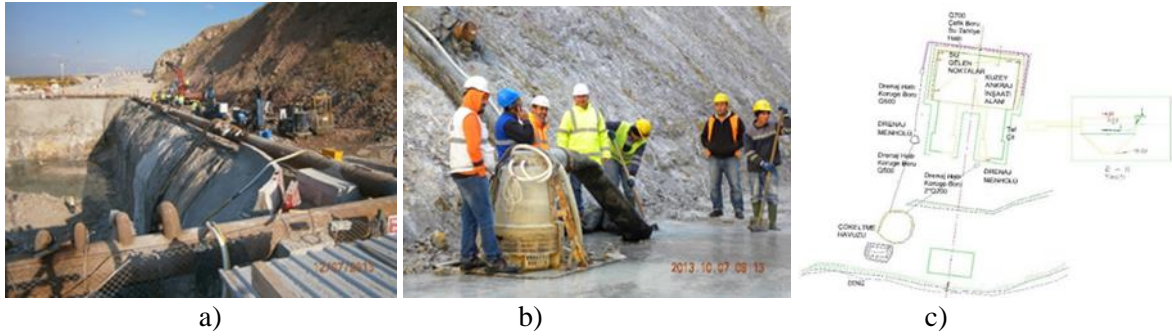
Şekil 5. a) Ankraj çevresi yatay drenaj hattı b) Kullanılan drenaj pompalarından birine ait görüntü c) Yatay drenaj hattı planı
