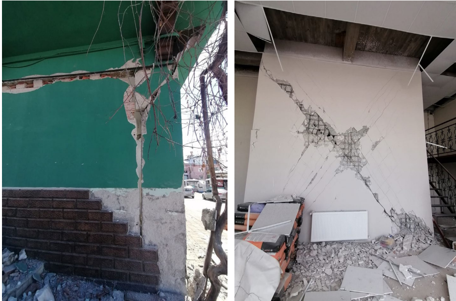
Şekil 9: Betonarme binalarda oluşan kesme hasarları Figure 9: Shear damage occurring in reinforced concrete buildings
