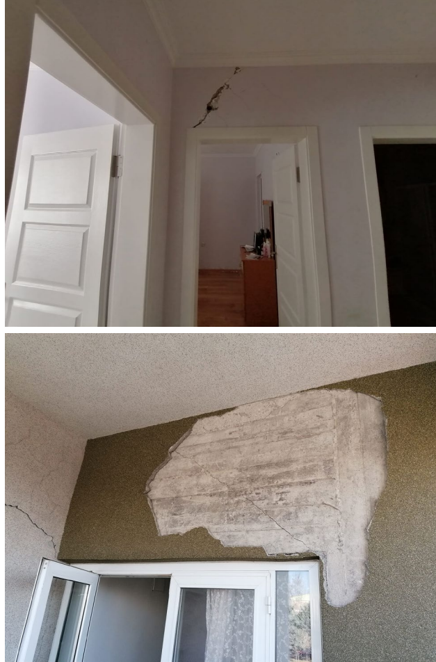
Şekil 15: Betonarme kirişlerde kesme hasarları Figure 15: Shear damage in reinforced concrete beams
