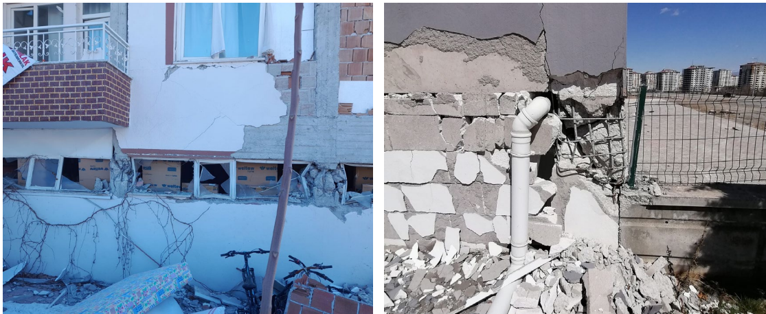
Şekil 11: Kısa kolon nedeniyle oluşan hasarlar Figure 11: Damage caused by short columns
