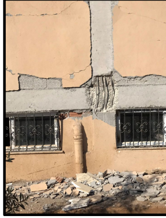
Şekil 16: Kısa kolon oluşumundan dolayı hasar almış bina örneği, Kahramanmaraş (Kirtel 2023)
