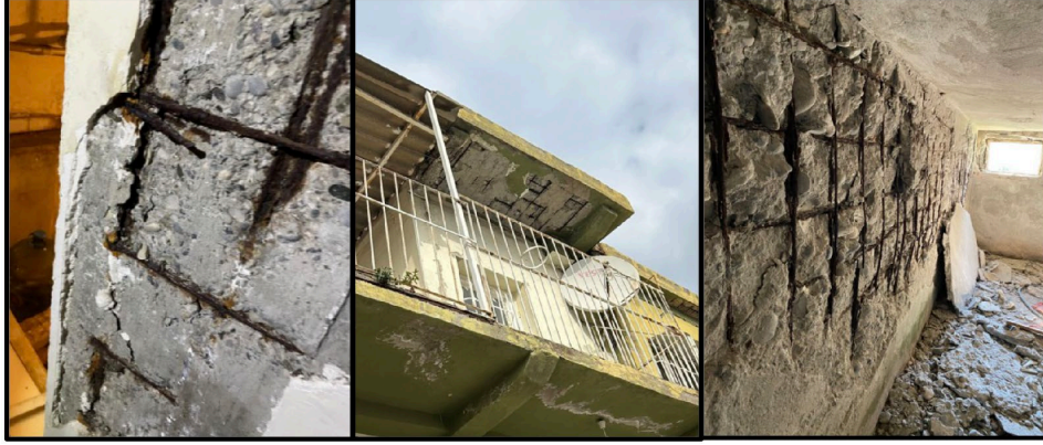
Şekil 22: Korozyona uğramış betonarme donatısı, Hatay (TMMOB MO ve İMO İzmir Şb. 2023) Figure 22: Corroded reinforced concrete reinforcement, Hatay (TMMOB MO and İMO İzmir Br. 2023)
