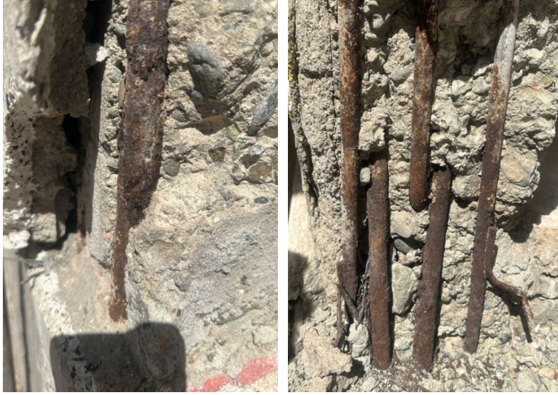
Şekil 13: Betonarme elemanlarda meydana gelen donatı korozyonu Figure 13: Reinforcement corrosion occurring in reinforced concrete elements
