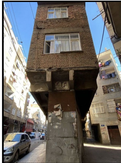
Şekil 20: Kütle merkezi yukarıda olan bina örneği, Diyarbakır (Uyandırmasservice 2023) Figure 20: Example of building with center of mass above, Diyarbakır (Uyandırmasservice 2023)
