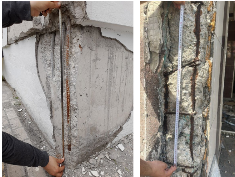
Şekil 6: Betonarme elemanlarda yetersiz etriye aralığı Figure 6: Inadequate spacing of stirrups in reinforced concrete elements
