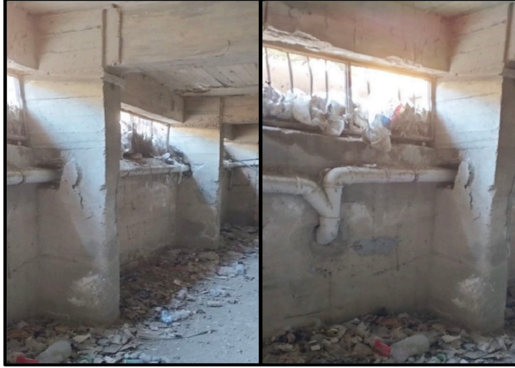
Şekil 24: Taşıyıcı sistem elemanlarına zarar verilmesi, Hatay (TMMOB MO ve İMO İzmir Şb. 2023) Figure 24: Damage to structural system elements, Hatay (TMMOB MO and İMO İzmir Br. 2023)
