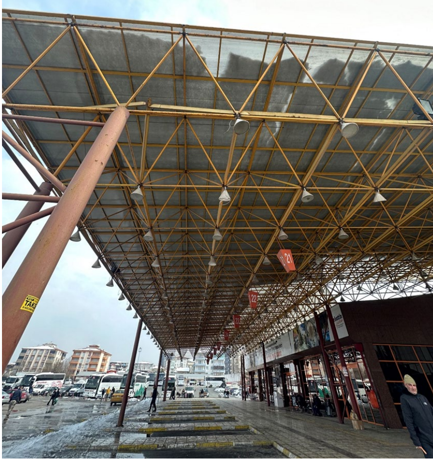
Şekil 21: Çelik uzay kafes çatı sistemi (38.34198° K, 38.25576°D) Figure 21: Steel space truss roof system (38.34198° K, 38.25576°D)
