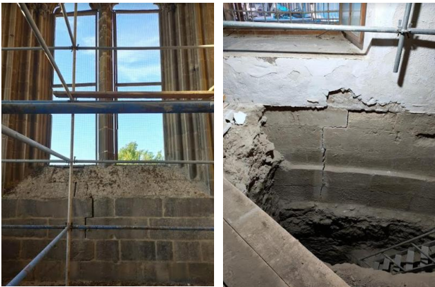
Şekil 10. Çan kulesi pencere altlarında oluşan derz boşlukları ve çatlaklar.
