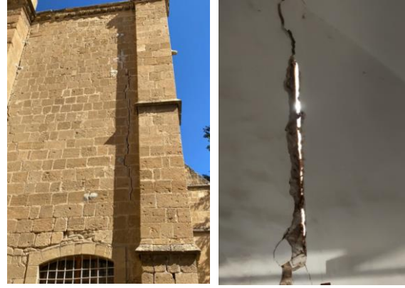
Şekil 11. Şapel bölümü duvarında meydana gelen ayrılma.
