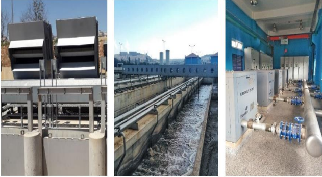
Şekil 8. Kaba-ince ızgara, kum yağ tutucu ünite ve kum yağ tutucu blower üniteleri
