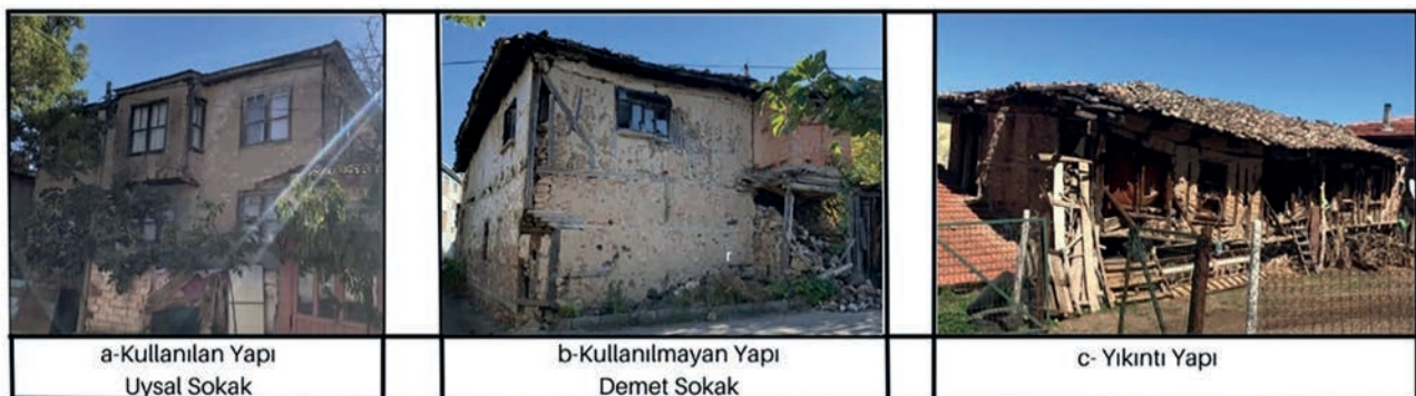
Levha 7. Kullanım durumuna göre yapı örnekleri / Examples of structures by use (Öztürk, 2022).
